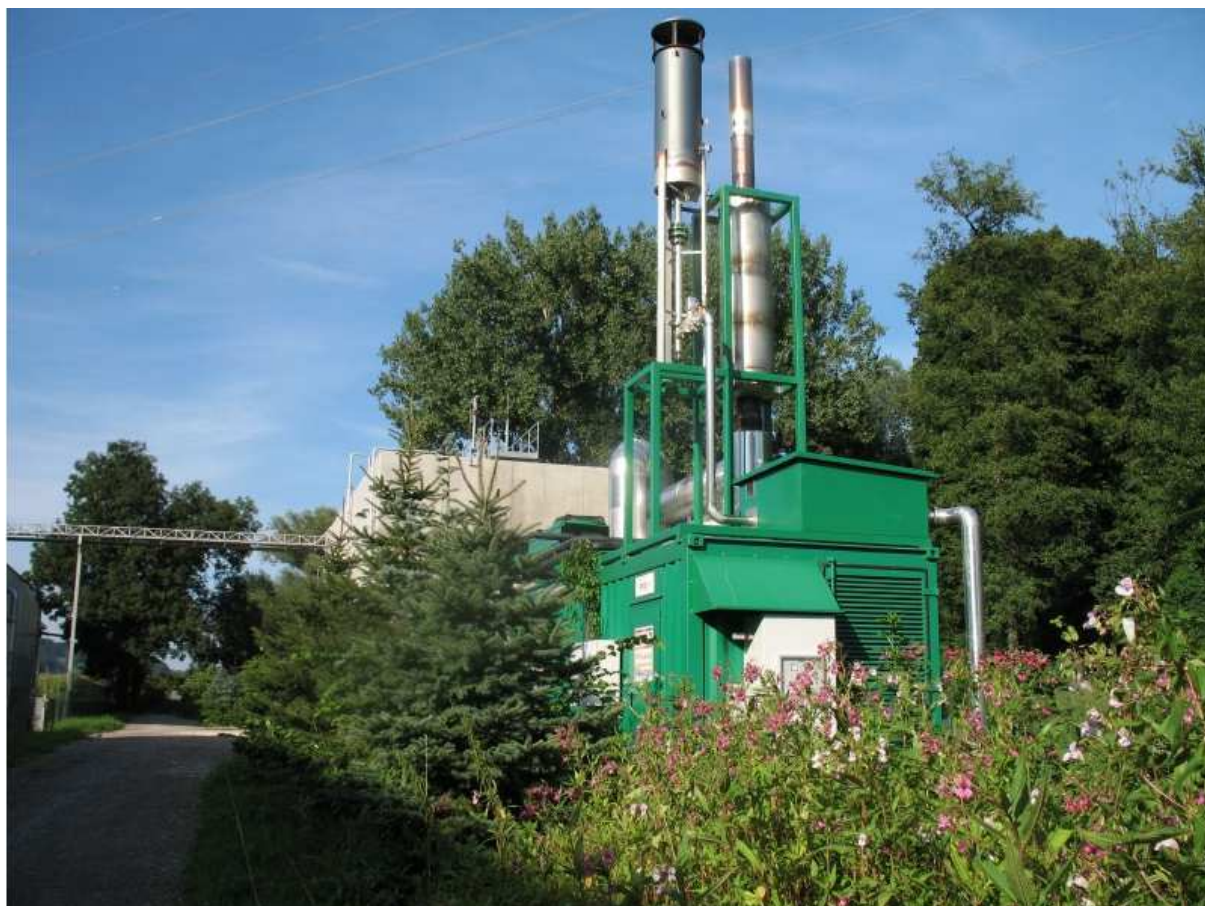
Blok generatora (źródło: biopower.com.pl)
